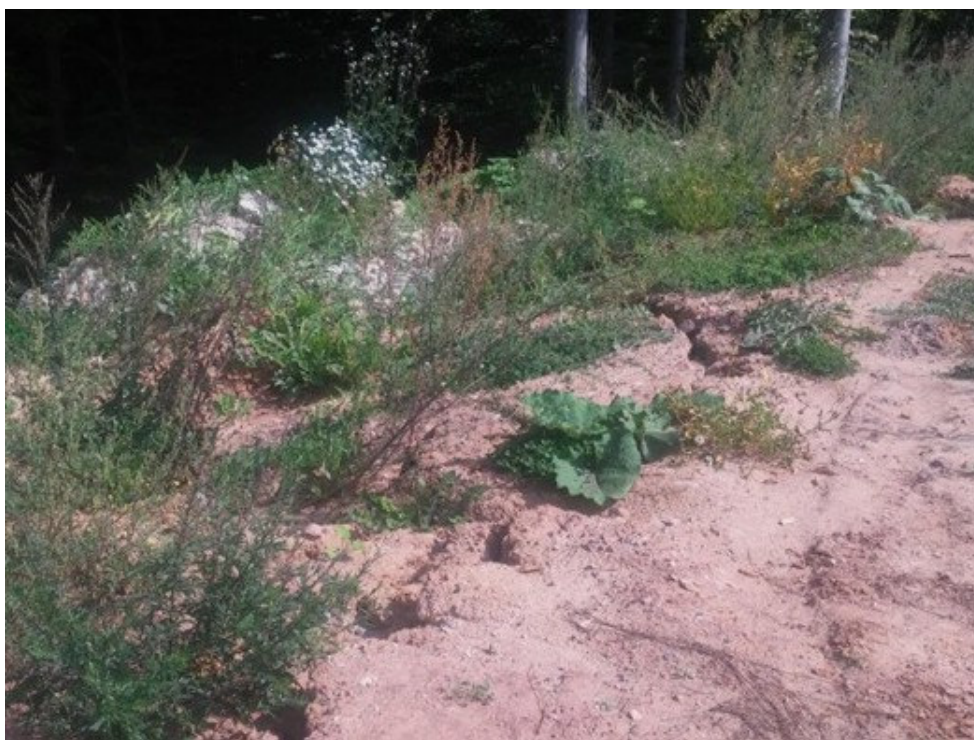
Ryc. 6. Spękania gruntów nasypowych nad skarpą główną osuwiska nr 13
