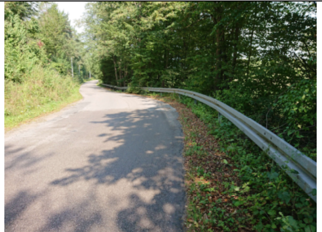
Droga powiatowa nad górną krawędzią osuwiska
