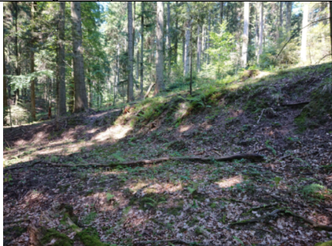
Świeża skarpa górna osuwiska
