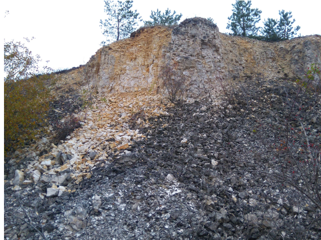
Widok powierzchni oderwania z osypiskiem skalnym poniżej.
