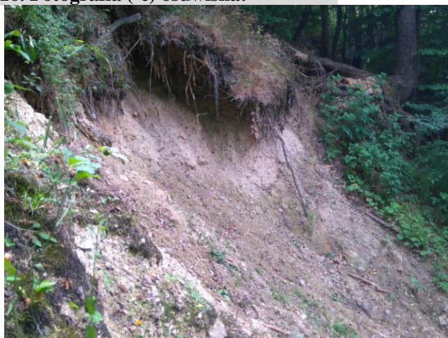
Widok skarpy głównej osuwiska.
