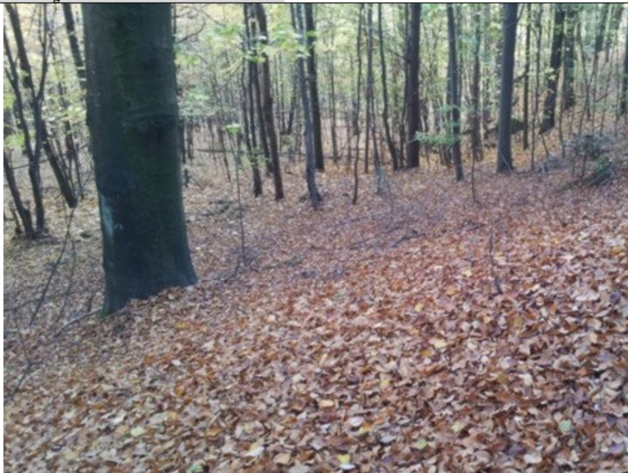
Ogólny widok osuwiska.
