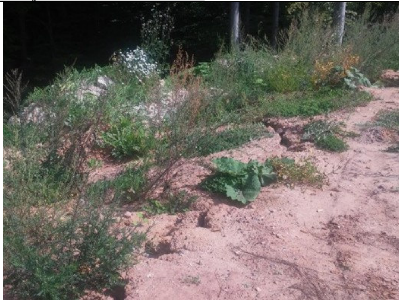
Spękania gruntów nasypowych nad skarpą główną osuwiska nr 13
