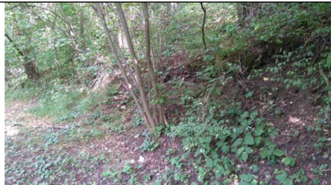
Widok dolnej części osuwiska
