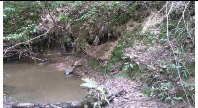
Osuwisko w dolnej części
