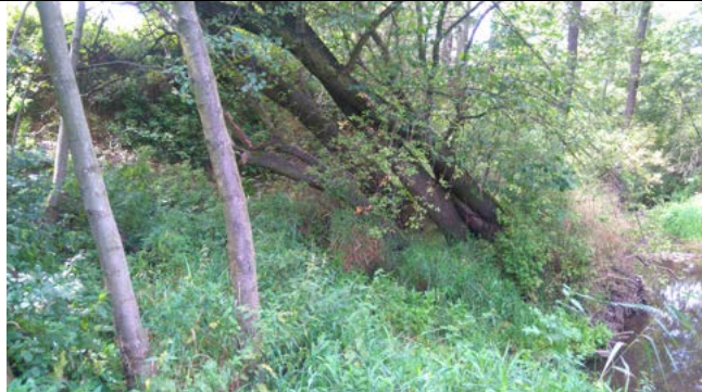
Widok ogólny osuwiska.
