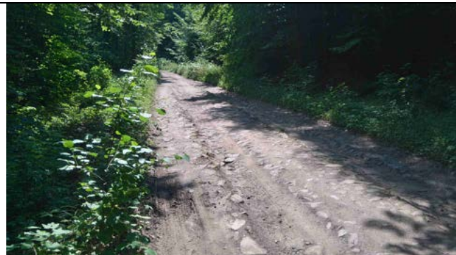
Droga brukowana przebiegająca przez osuwisko
