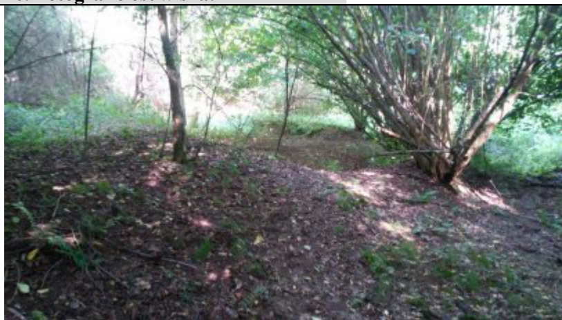
Ogólny widok osuwiska.
