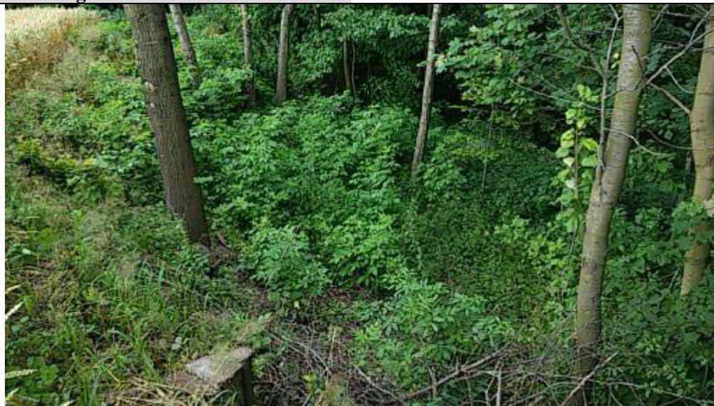
Ogólny widok osuwiska.
