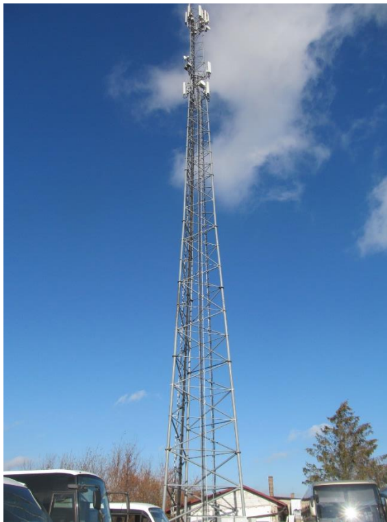
Zał. nr 1: Widok ogólny instalacji radiokomunikacyjnej.
